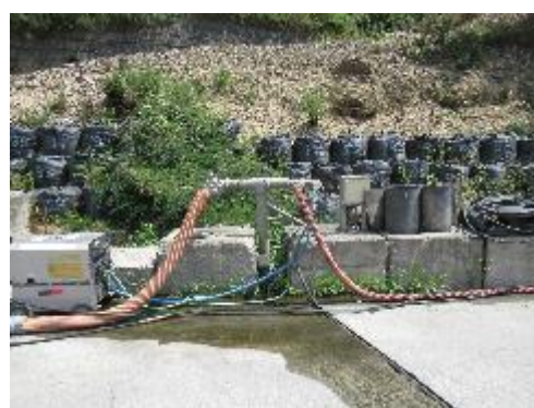
地下水くみ上げ設備
