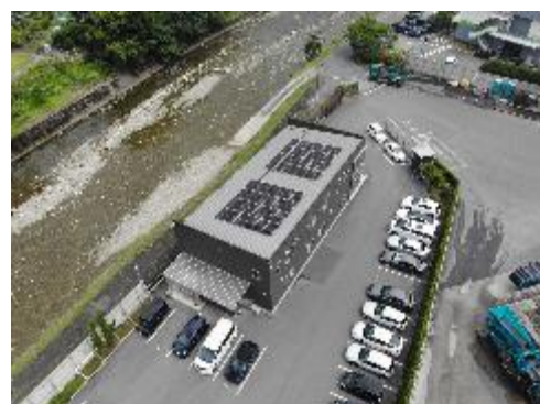
本社屋根に設置した太陽光パネル
